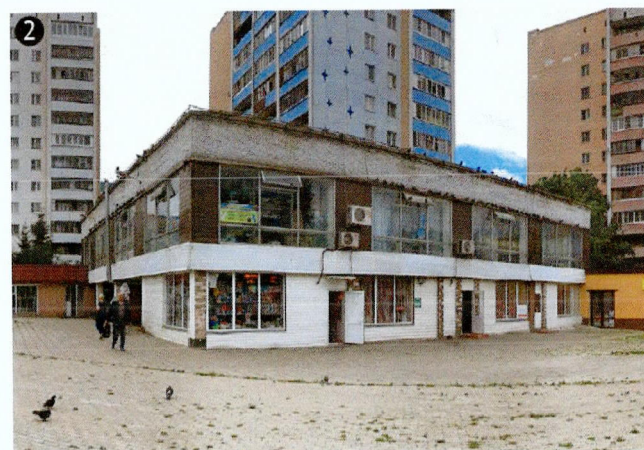
Неудовлетворительное состояние покрытий
